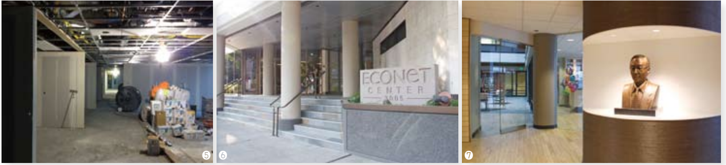
5 실내 공사 중인 유니베라 사무실 Univera office space [1st fl.] 6 새 에코넷센터 현관 New ECONET sign for new building 7 새 에코넷센터의 고 이연호 회장의 흉상 Yunho Lee Honorable Bust alcove
